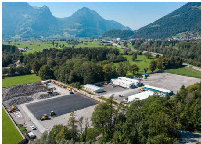
Hauptinstallationsfläche im Portalbereich Gäsi
